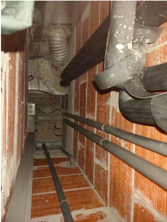
Espai vertical destinat al pas d'instal·lacions, des de la coberta a la planta baixa.
