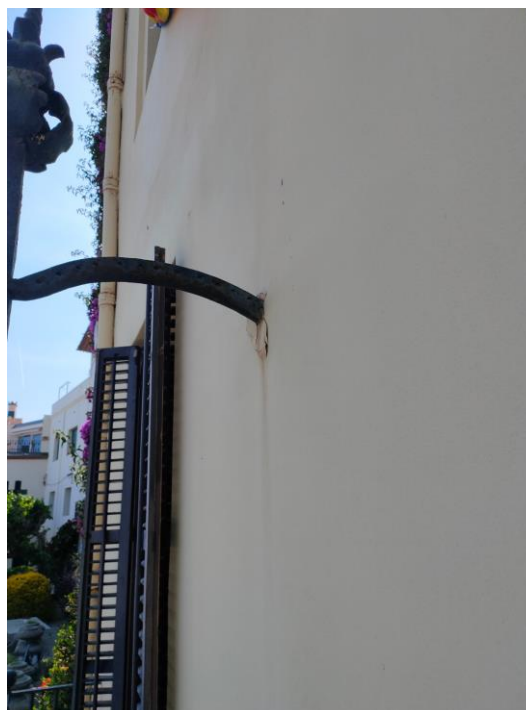
Oxidació de l'element central del balcó.
