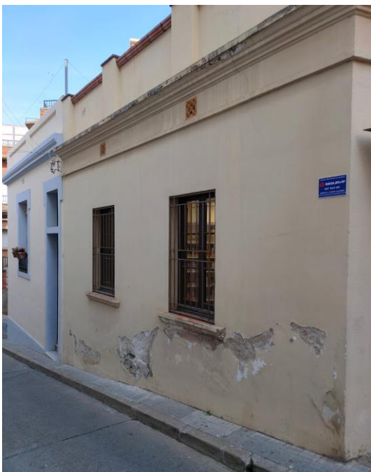
Revestiment en mal estat.
