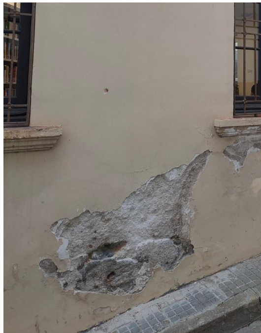
Detall del revestiment en mal estat.
