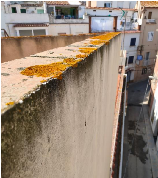
Revestiment afectat pels regalims d'aigua.
