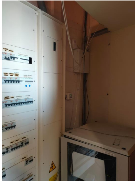
Armari de l'entrada, on es col·locarà l'inversor, a la paret de la dreta (façana nord-est).
