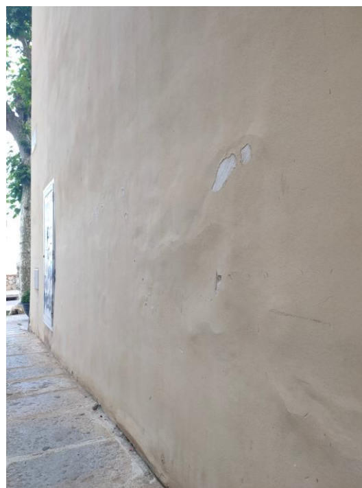
Detall del revestiment afectat per humitats de capil·laritat.
