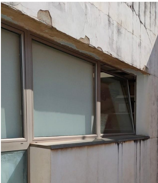
Detall del despreniment del revestiment.
