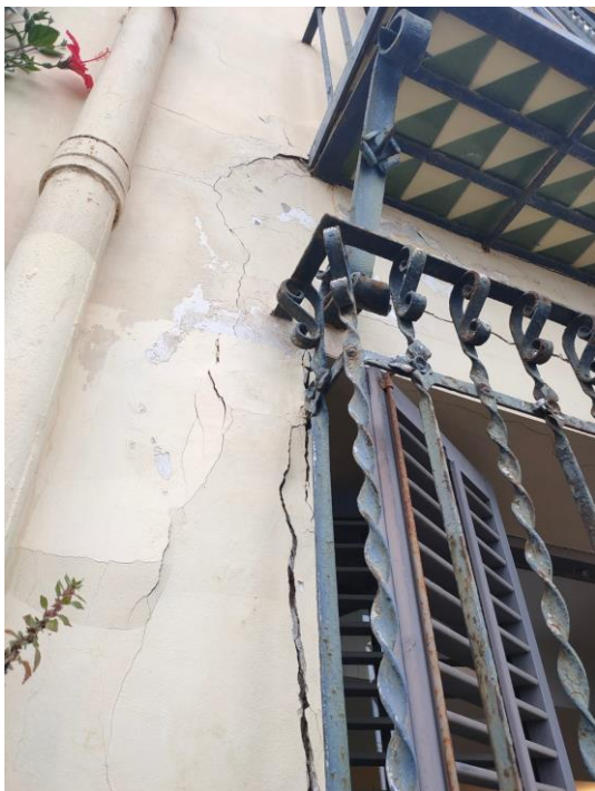
Oxidació de la reixa de planta baixa i suport del balcó.
