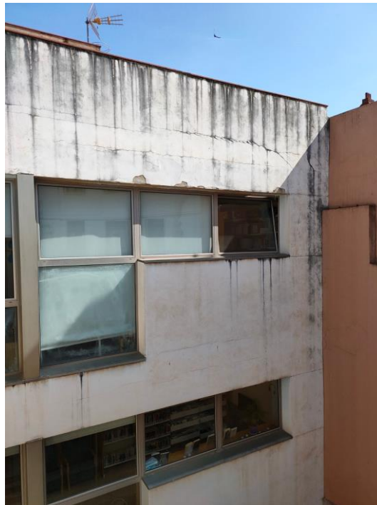
Detall de l'esquerda horitzontal de planta segona i coberta.
