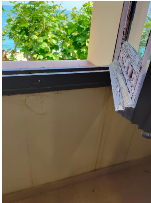
Finestra de planta segona, amb filtració d'aigua a l'interior.
