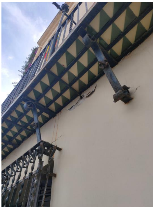
Oxidació dels suports i elements del balcó.
