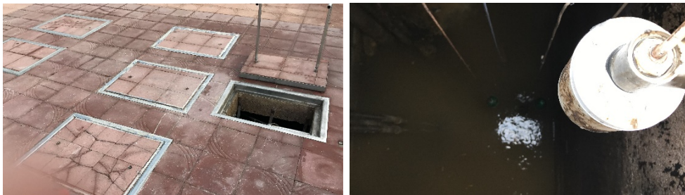
Figura 4.15: Imatges corresponents a la EBAR “Mirador”.
