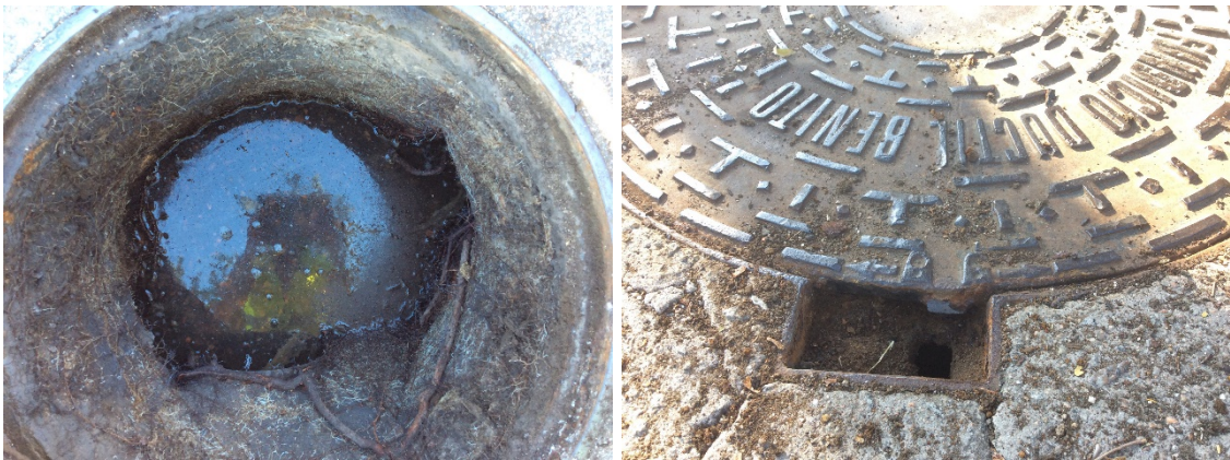
Figura 6.3: Exemples d'un pou amb arrels i d'una tapa trencada.
