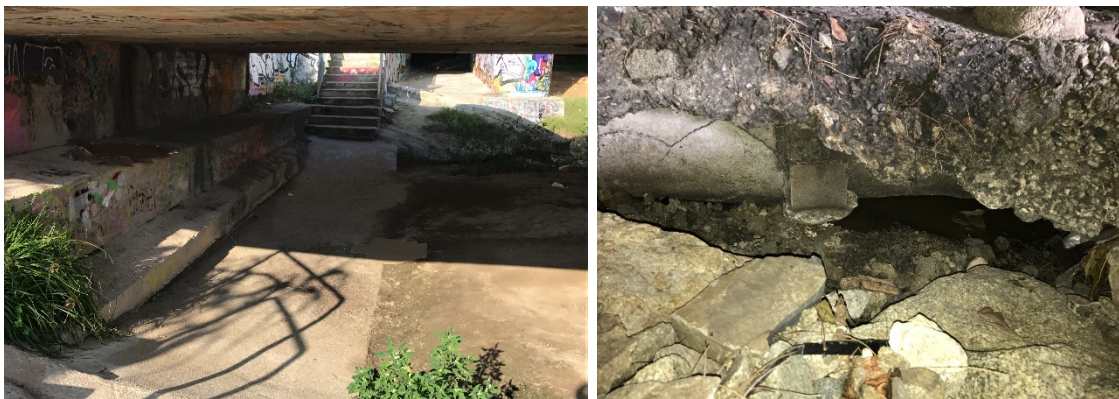
Figura 4.11: Mal estat del col·lector que creua el pas inferior.
