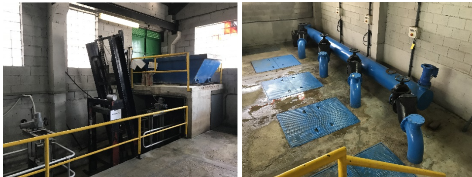
Figura 4.14: Imatges corresponents als equips d'impulsió de la EBAR "Emissari".
