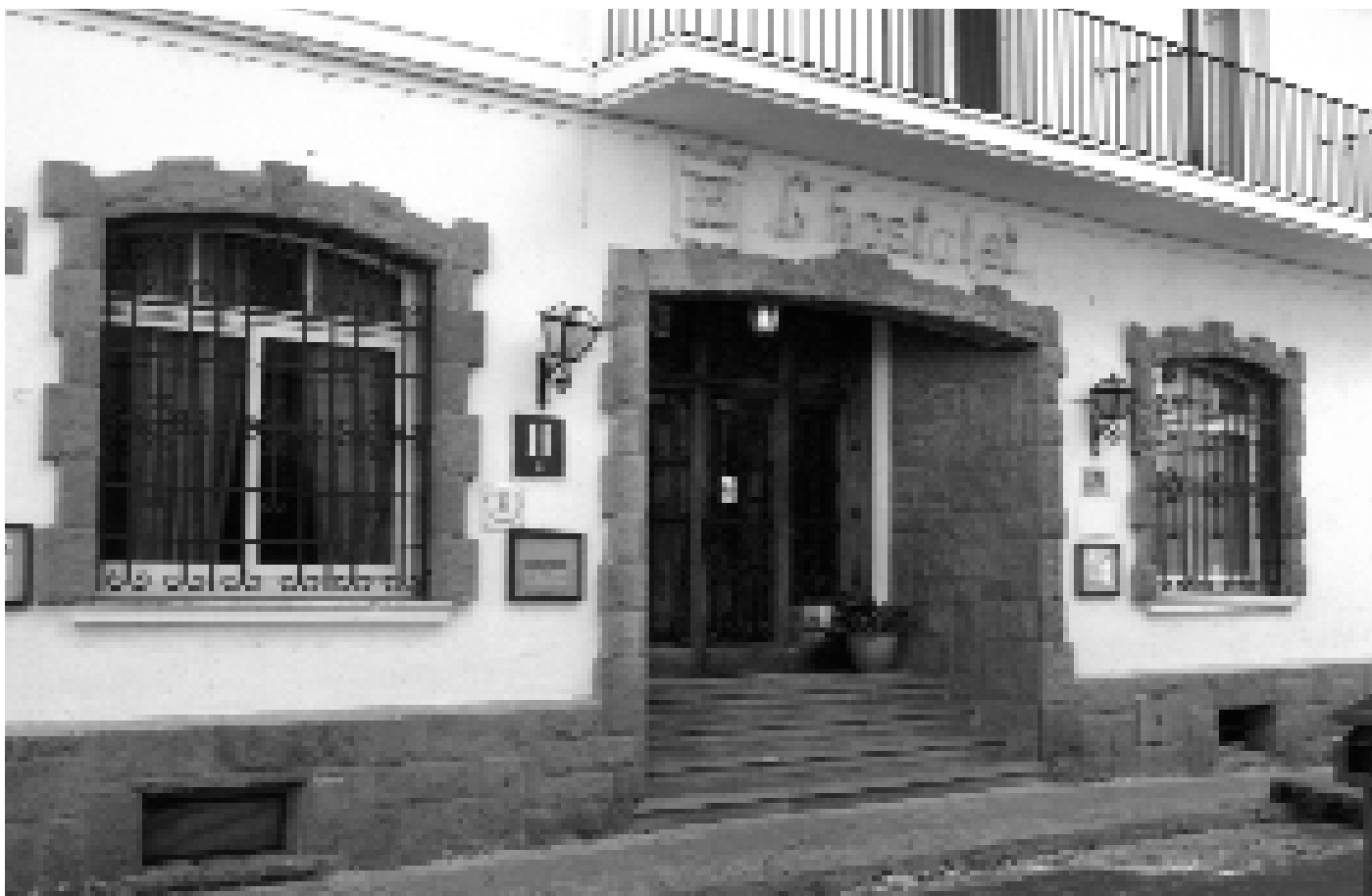
La façana de la futura Llar d'Avis Sant Pol, actualment en obres. / Foto: Ester Sauleda
