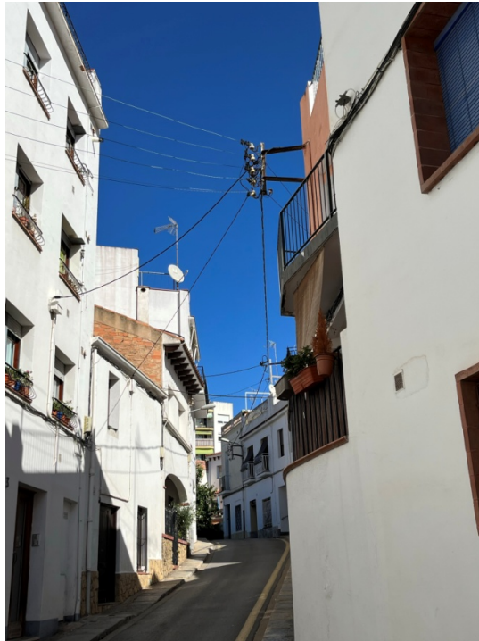
Fotografia 15.- Encaballats i suport de l'estesa aèria a eliminar
