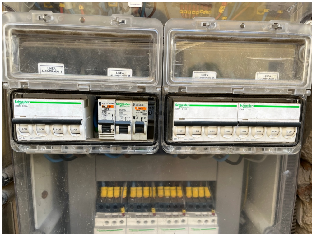
Fotografia 6.- Fusibles, contactors i proteccions
