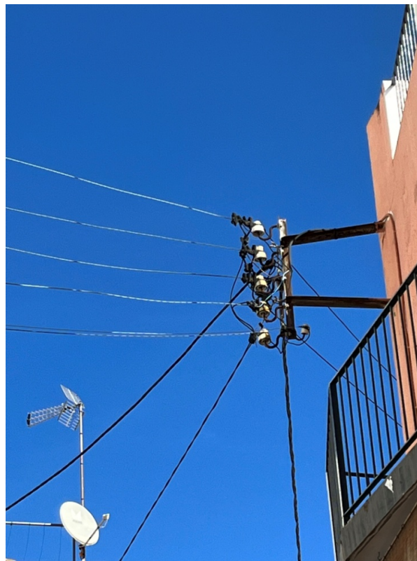
Fotografia 14.- Encaballats i suport de l'estesa aèria a eliminar
