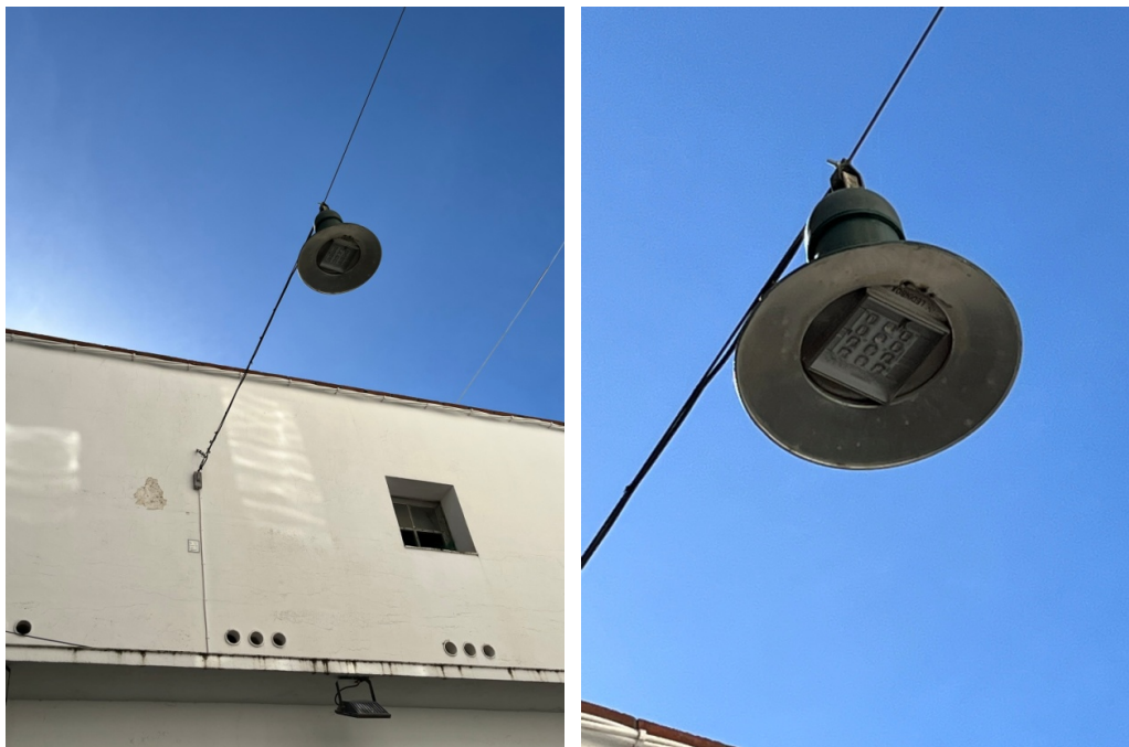
Fotografia 16.- Llumineres suspeses del Carrer Nou
