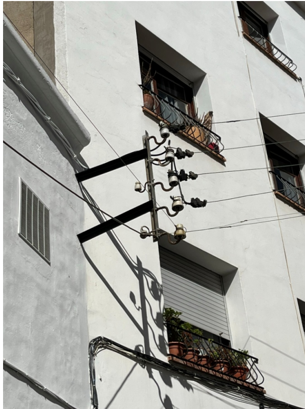
Fotografia 13.- Encaballats i suport de l'estesa aèria a eliminar
