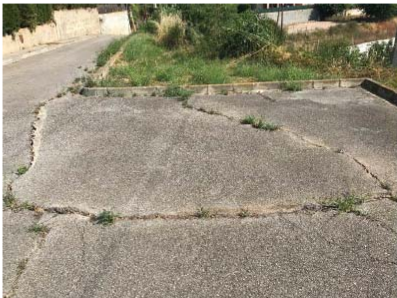
Figura 6: Fissures al C/Mariano Cirer Sala - zona eixamplament
