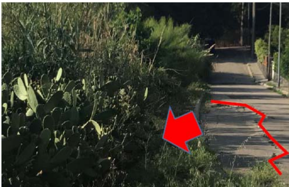
Figura 4: Fissures al C/Mariano Cirer Sala – tram central
