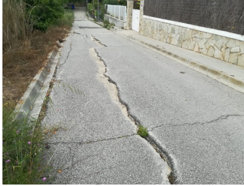
Il·lustració 1. Fotografia de les fissures superficials.
